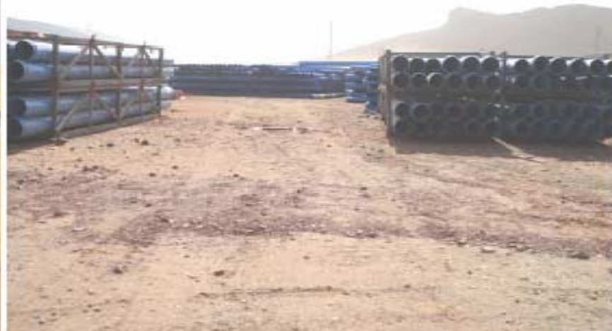
Tuyaux destinés à la conduite d'eau saline.
